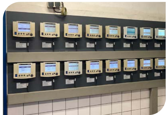
Abb. 5: WTW IQ SENSOR NET-Controller im Kontrollraum
